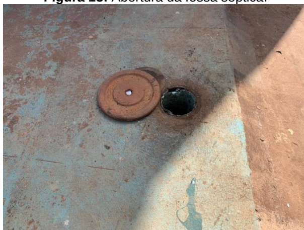
Figura 13: Abertura da fossa séptica.
